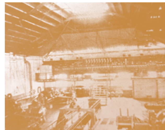
Interior de la usina a principios de 1896, mirando hacia el tablero. A la izquierda, dos de los grupos de 80kW. Al frente, uno desarmado.
